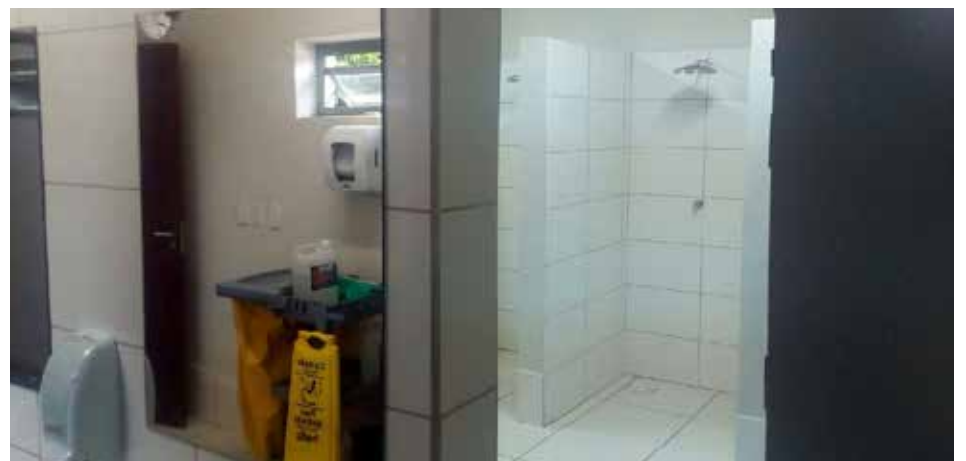
Banheiros sem portas no Complexo Barro Duro em Cuiabá expõem a privacidade dos trabalhadores e o quanto a Energisa MT não respeita as pessoas
